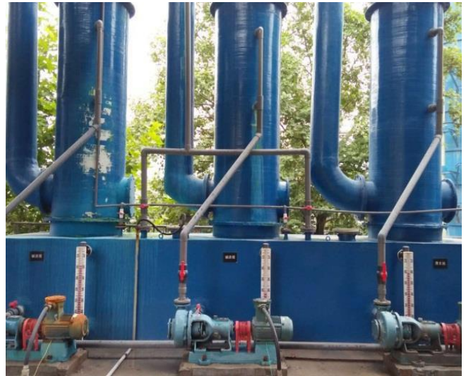
液氯泄漏处置装置
