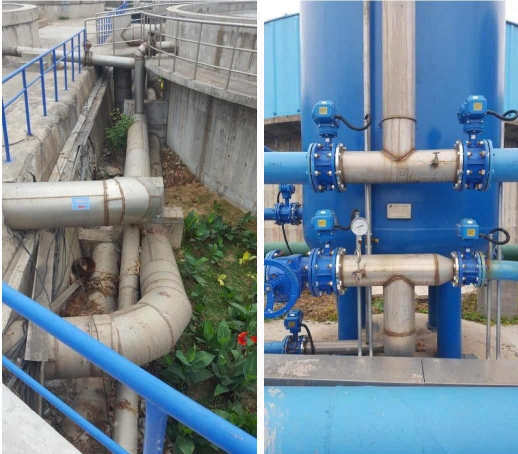
图 4.2-6 污水处理装置和设备
