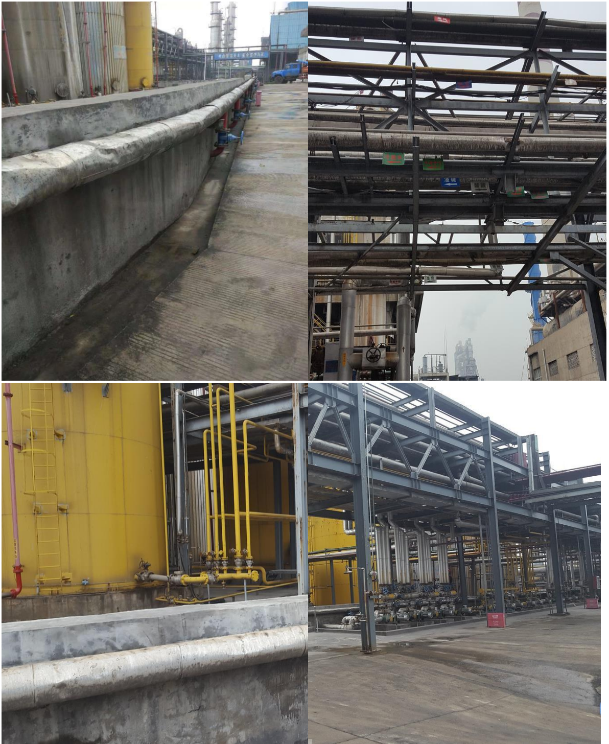
图 4.2-3 厂内液体运输管道
