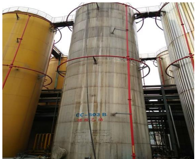
储罐消防设施
